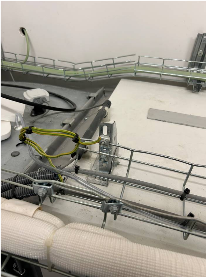
Figure 2 : Assurer la continuité de la mise à terre du (des) conducteur(s) de protection (L1: 5.4.3.5)
