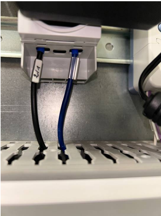
Figure 3 : Prise(s) : le contact de terre est à relier à la terre de l'installation (L1: 5.3.5.2.).
